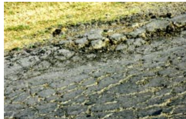
El Acceso Colón resquebrajado
